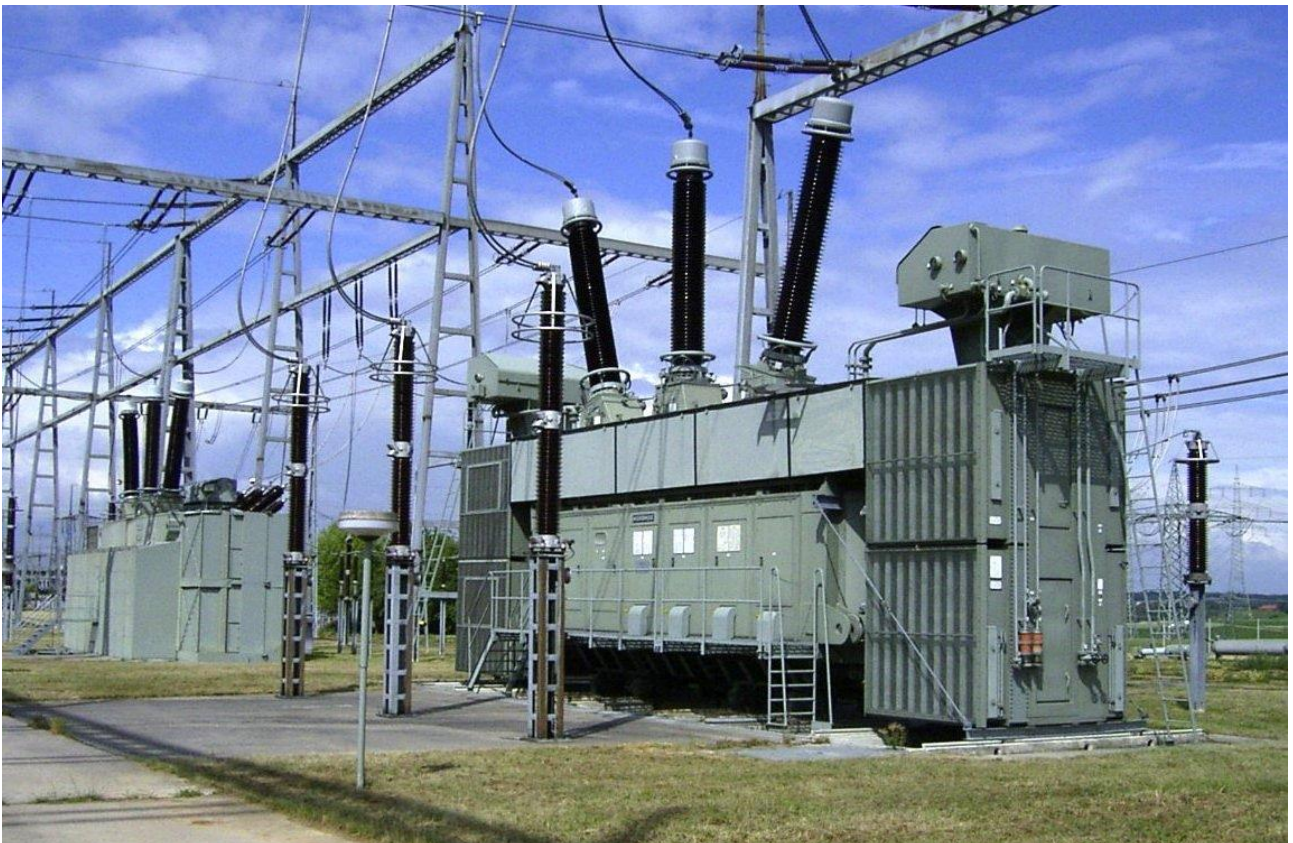
Un transformateur de puissance dans un poste électrique (Wikipédia)
