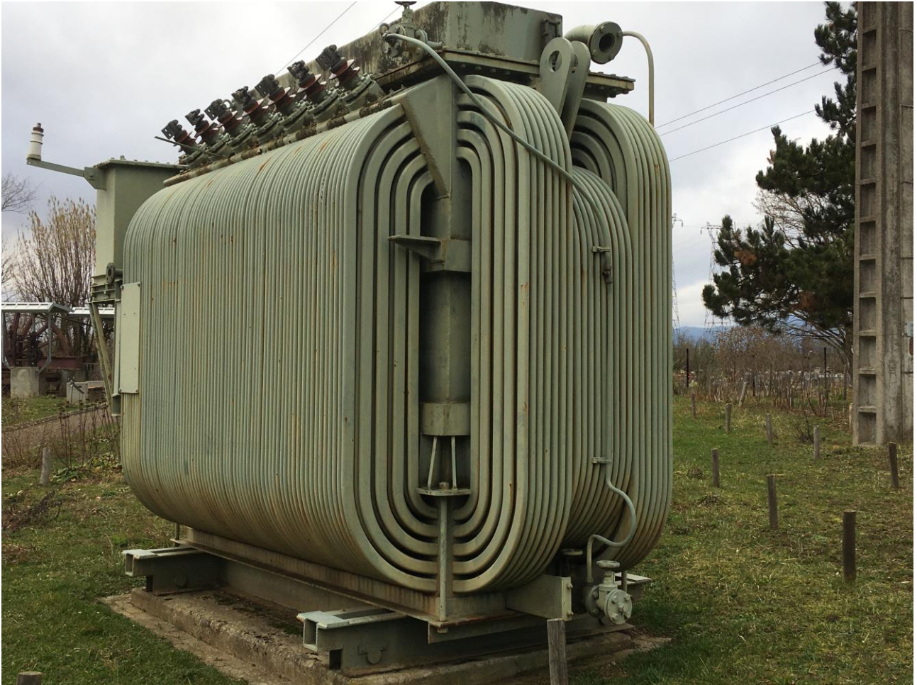
Transformateur de puissance électropolis (Mulhouse fev 2024)
