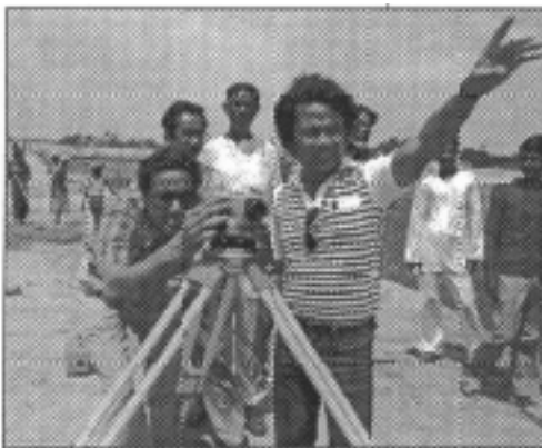
Un volontaire philippin de l'ONU aide à construire une nouvelle route au Bangladesh UNDP World Development, Novembre 1989.
